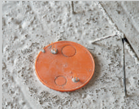
Detalle de incorporación de caja eléctrica.
