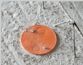
Detalle de incorporación de caja eléctrica.
